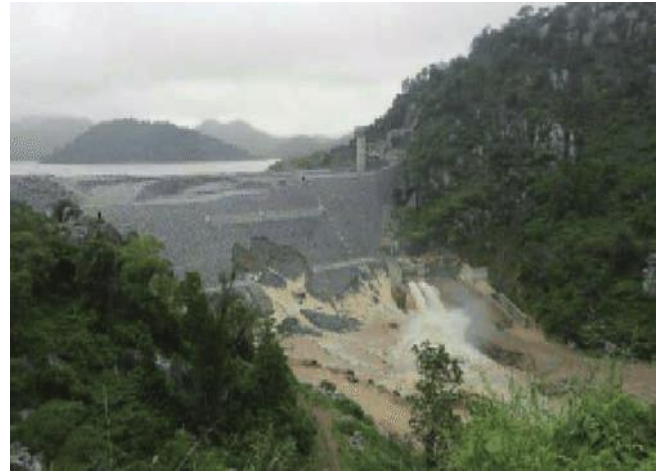
b) Failure of the Tokwe-Mukosi Dam-Zimbabwe (Lempérière, 2017)
